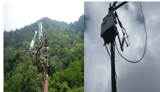
版纳站和哀牢山站更新的地表蒸散观测设备
